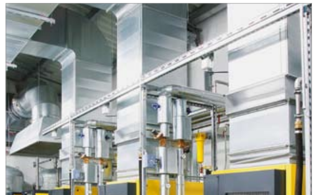
Abluftkanal zum Heizen benachbarter Räume
